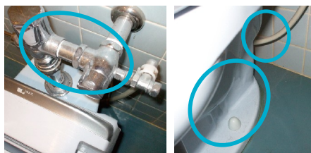
衛生陶器背面のパイプもチェック 壁面にもホコリと汚れ
