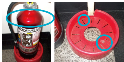
消火器の肩にもホコリ 受け皿にもホコリがたまっています！
